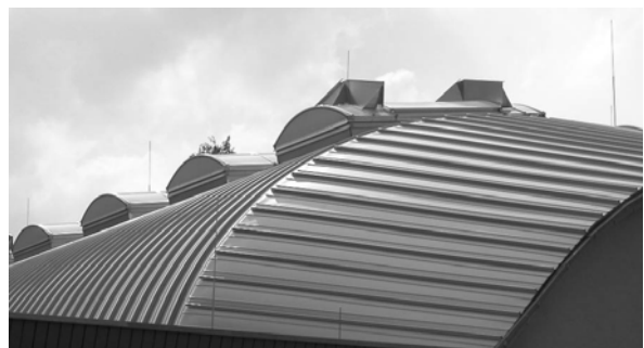
Bild 4.1.b: Metaldach an einem öffentlichen Gebäude der Stadt Soest. Die Dachaufbauten sind mit Fangeinrichtungen versehen. Das Metaldach ist geerdet.
